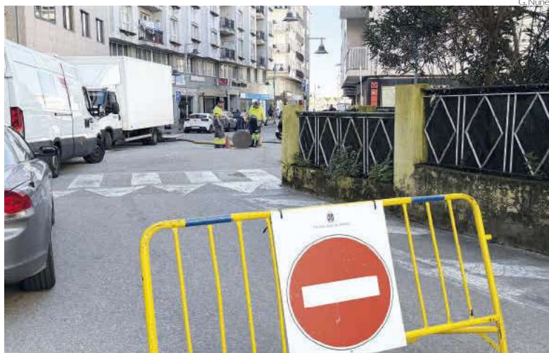
La calle Noria, cortada al tráfico, ayer, para realizar tareas de evacuación de los garajes de los edificios
